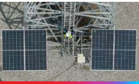
Solar Cell โครงข่ายเสาสัญญาณ
